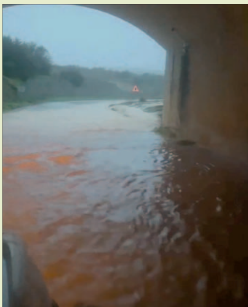
FOTO-DENUNCIA. Zona anegada en los bajos del Puente de la Azucarera.
