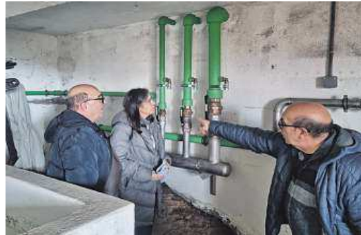
Las tuberías del IES de Beade son plásticas.
