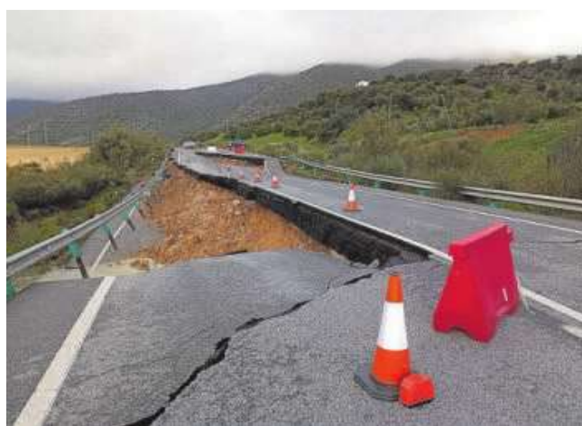
Vista de la carretera dirección Ronda a Algodonales A374, destruida por el temporal. EFE
