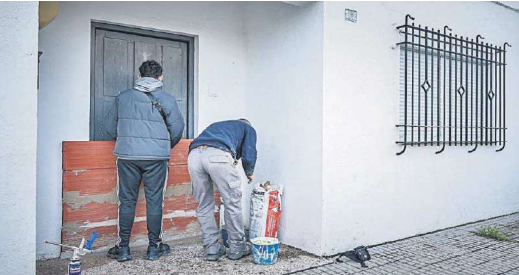
Vecinos del Poblado de Doña Blanca, en El Puerto, refuerzan su vivienda antes del desalojo.
